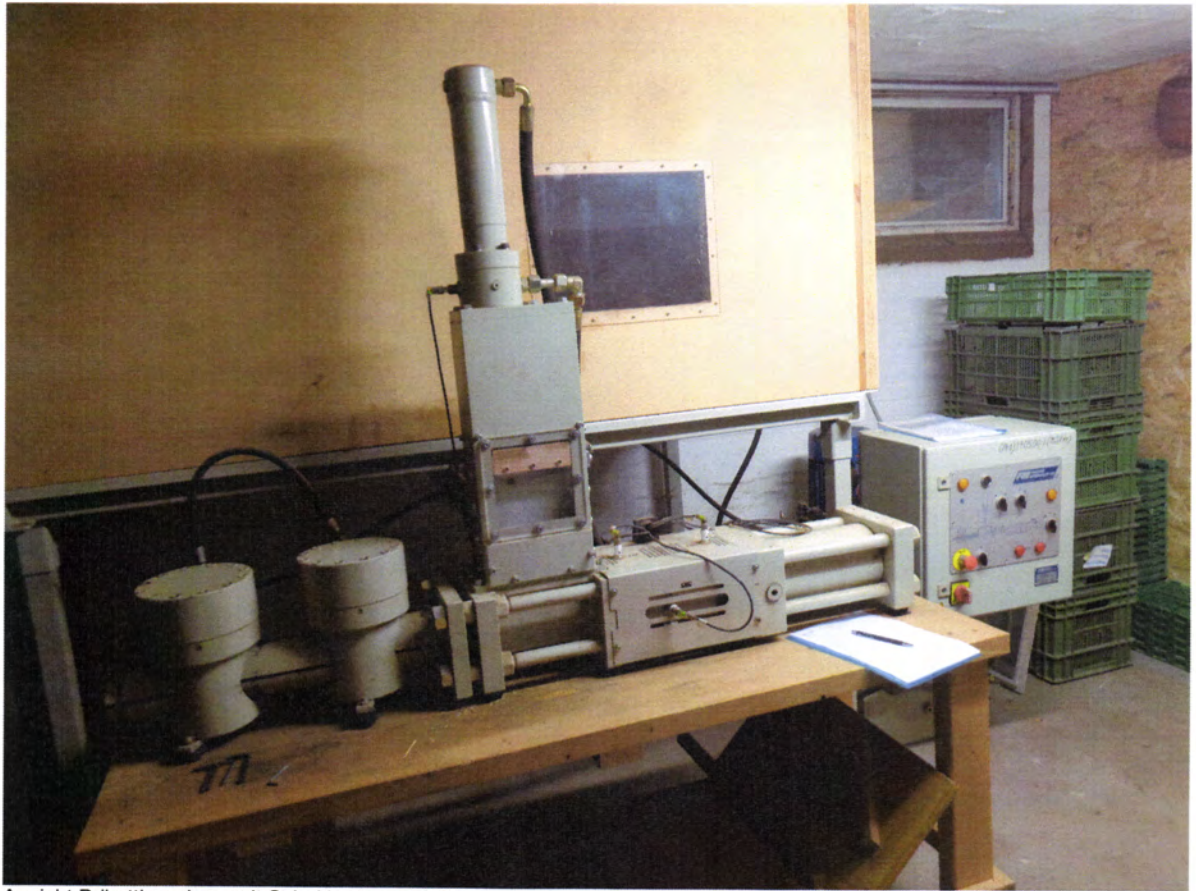
Ansicht Brikettieranlage mit Schaltkasten und Schubboden
